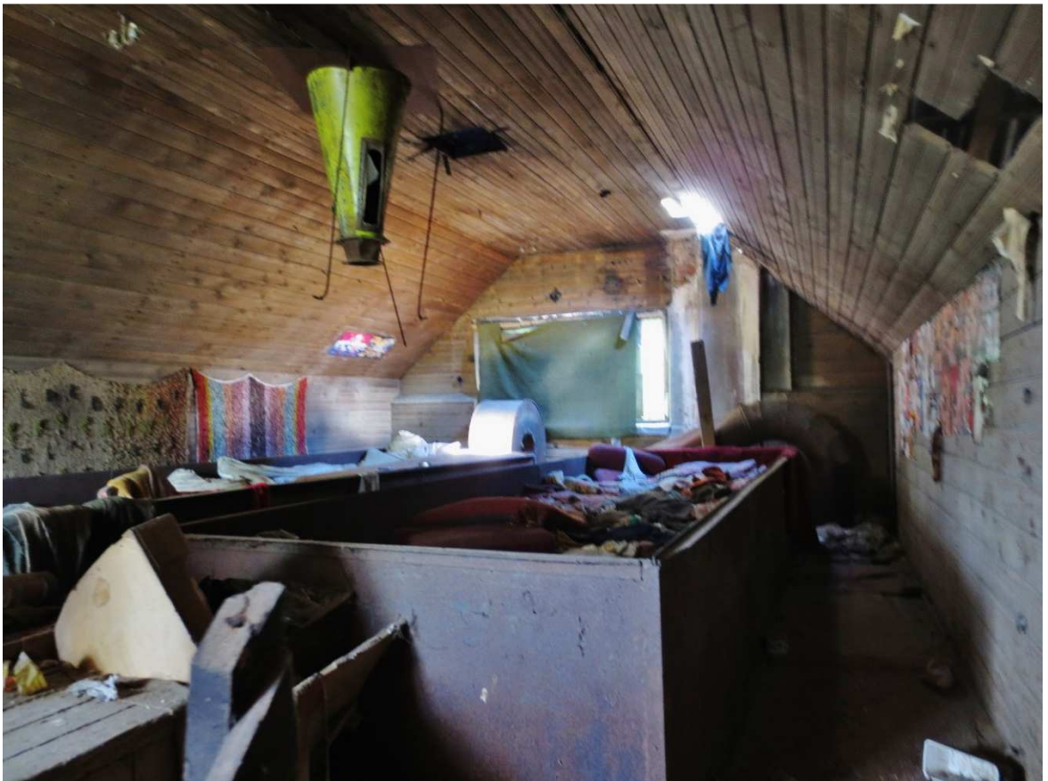
45. Vaade juurdehituse III korrusele, millel puudub ühendus ajaloolise hooneosa katusealusega
