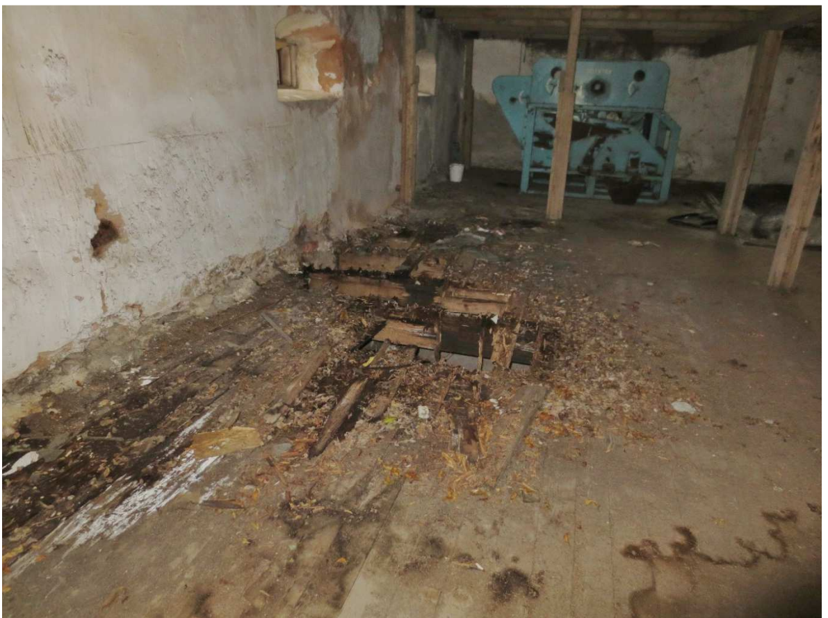
38. Katuse läbijooksu tõttu ulatuslikult kahjustunud põrand II korrusel
