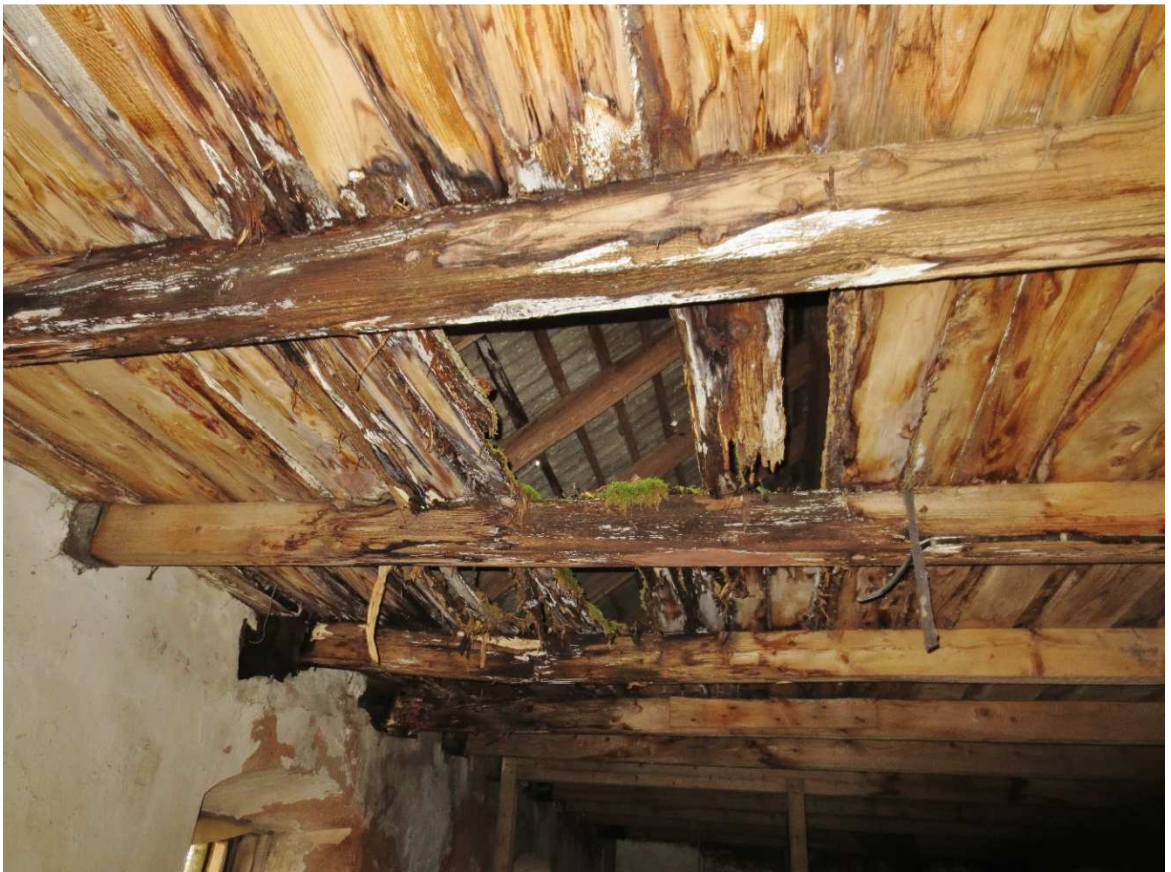
37. Katuse läbijooksu tõttu ulatuslikult kahjustunud vahelagi II korrusel
