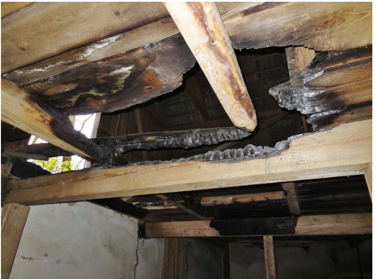
39 ja 40. Ulatuslikud põlengukahjustused II korruse vahelae kaguosas
