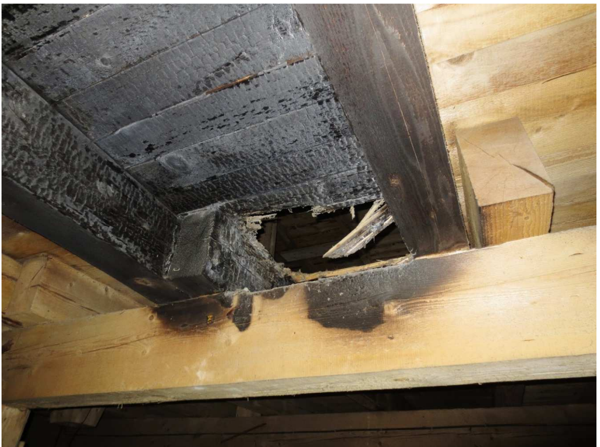
28. Põlengu kahjustus I korruse vahelael hoone kaguosas
