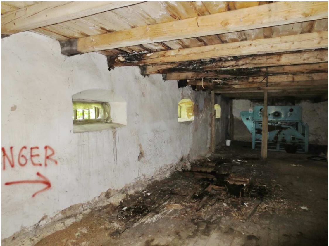
36. Vaade II korrusele lääne suunas. Ulatuslikud katuse läbijooksust tingitud vahelae kahjustused
