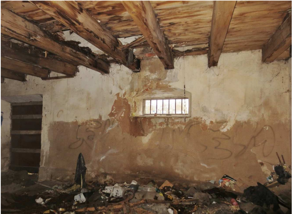
29. Ulatuslik vahelae kahjustus ja varing I korruse ukse U1 kõrval
